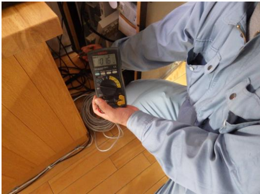
入力電圧確認
