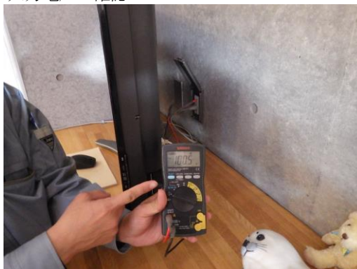
入力電圧の確認
