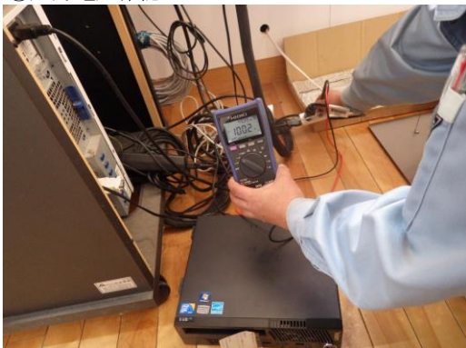
③入力電圧確認
