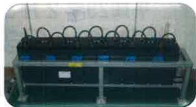
蓄電池(バッテリー)
