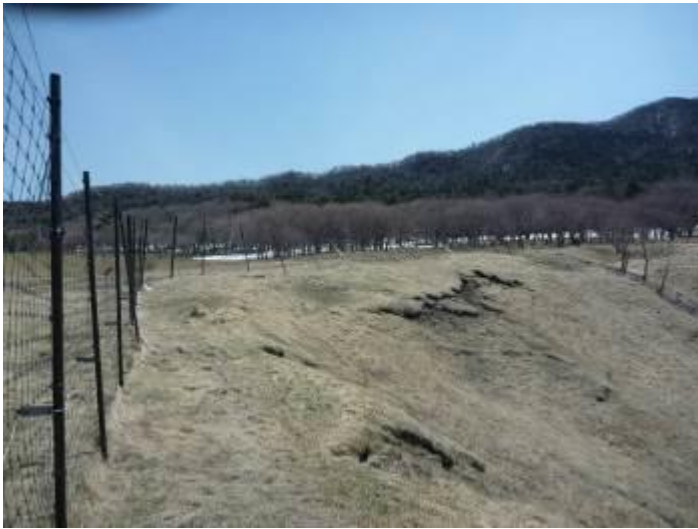
写真 C-4. 倒れ掛かっていた文吉湾付近の仕切柵の支柱（平成 26 年 4 月 30 日）
