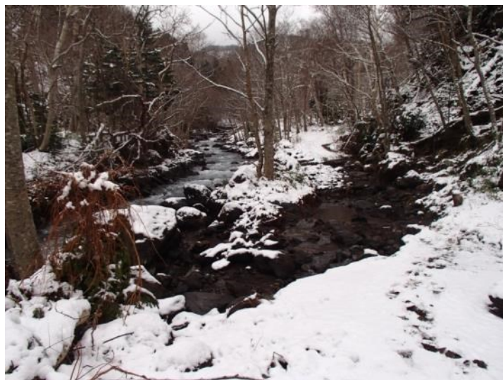
赤イ川左岸の作業道決壊状況（H25/12/3）
