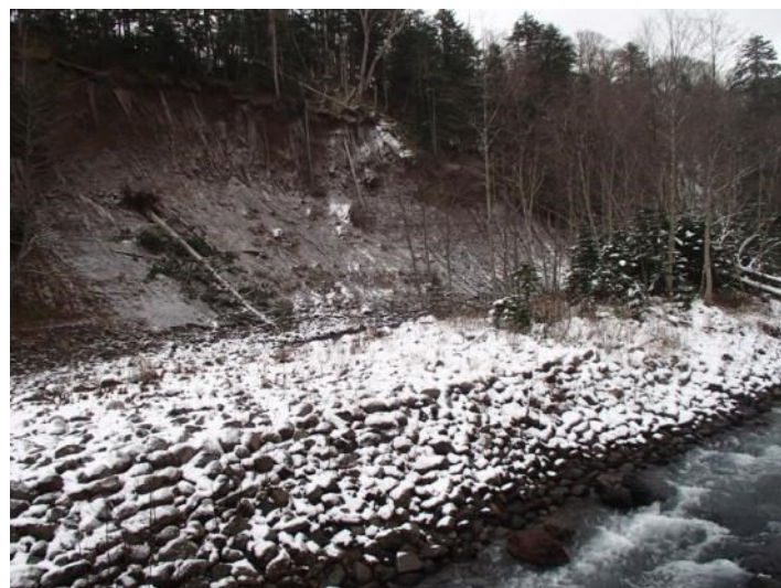
赤イ川No.12 鋼製えん堤上流右岸の倒木発生状況（H25/12/3）
