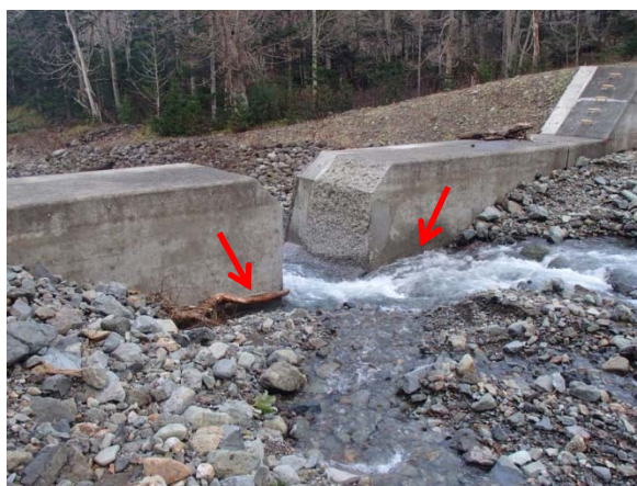
出水後の状況 (11 月 15)
