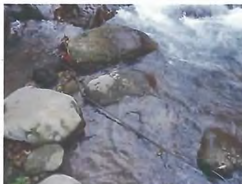
玉石連結ワイヤーの露出 (H22 年 10 月)
