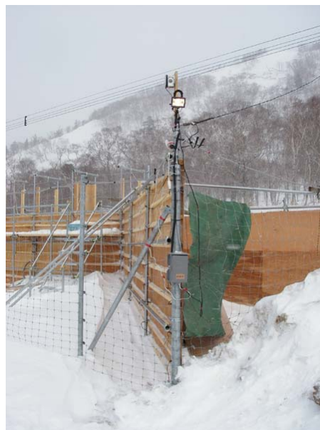
写真 2-8. 監視カメラと照明装置。
