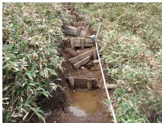
土砂が流出し破損した階段
