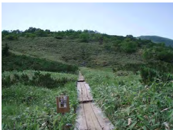
一の沼側の木道に不同沈下が生じている
