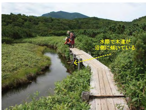
水際で沼側へ傾いている木道
