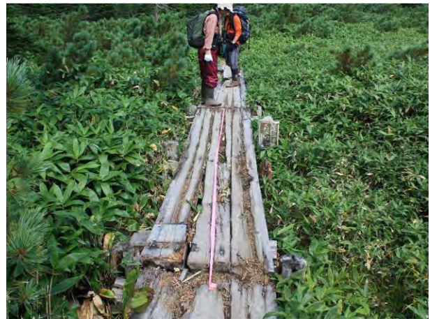
損壊・腐朽が著しい木道
