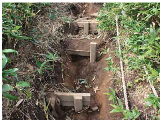
著しく浸食された歩道階段部
