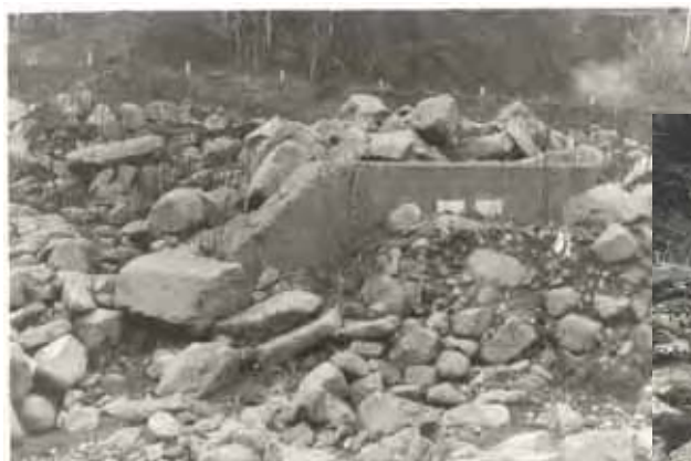
本流のダム破損埋没状況
