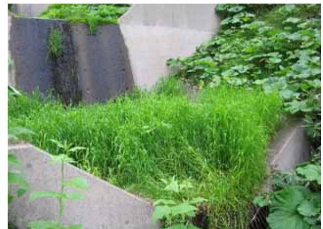
上流のコンクリートの状況。土砂が溜り草が生えている。
