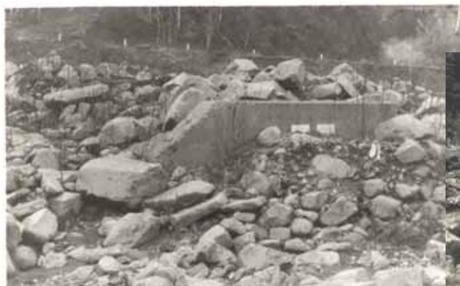
森林管理局No6ダム破損埋没状況
