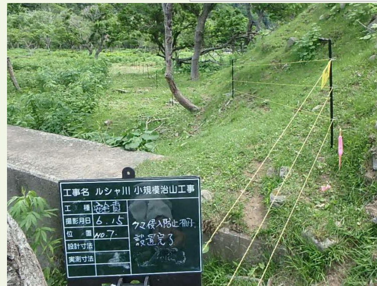
電気柵(工事期間設置)
