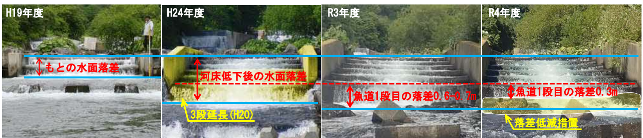
図 7 落差低減措置：落差が増大し、魚道を 3 段延伸したものの、さらなる河床低下により遡上困難となったため、R4 遡上期前に暫定措置として袋型根固を配置 (水面落差 0.7→0.3m)
