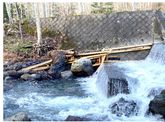
写真 2. 豪雨により破損した盤ノ川簡易魚道
