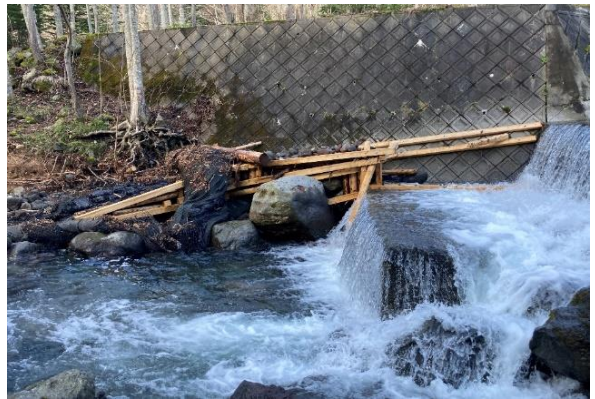
写真7. 半壊した簡易魚道 (2021年11月11日)
