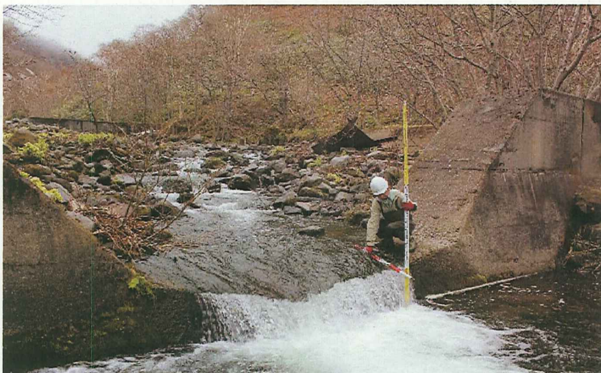
複断面放水路より0.90m洗掘
