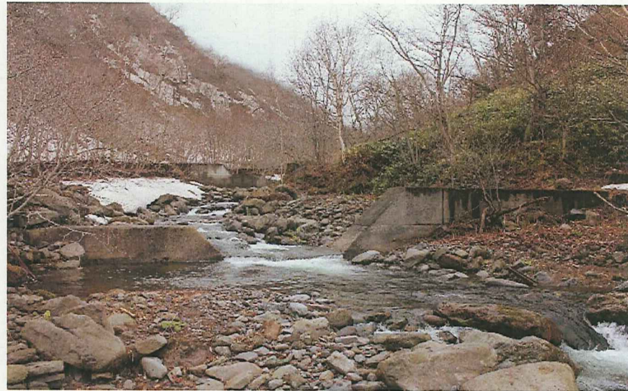
下流側 洗掘状況
