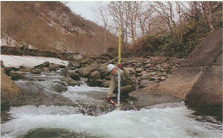
複断面放水路より1.00m洗掘
