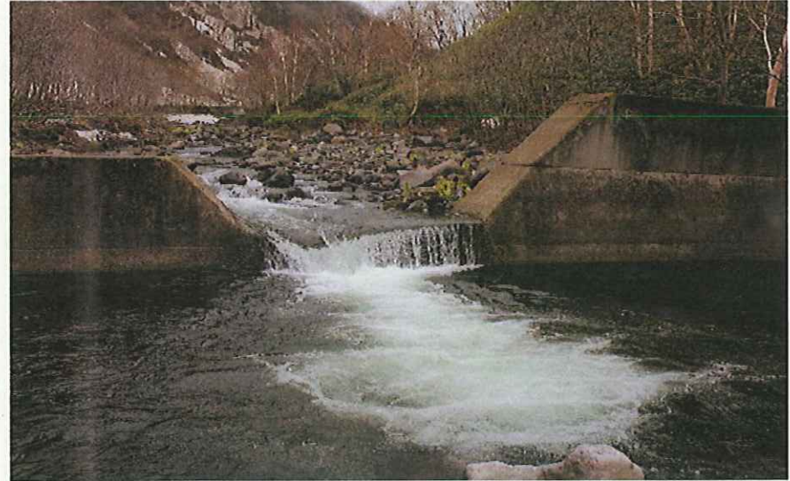
下流側 洗掘状況
