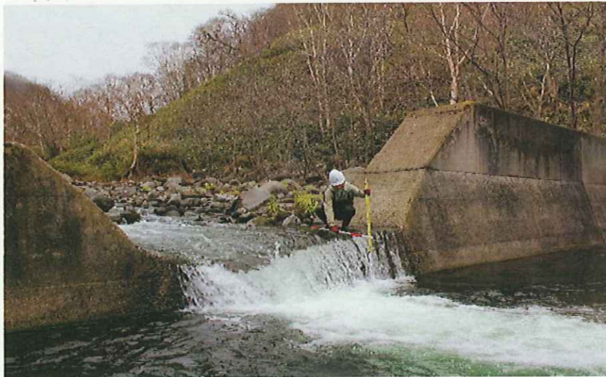
複断面放水路より2.20m洗掘
