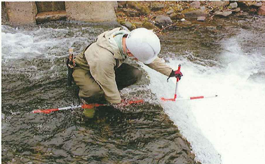
複断面放水路より1.60m洗掘
