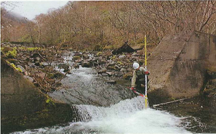
複断面放水路より0.90m洗掘
