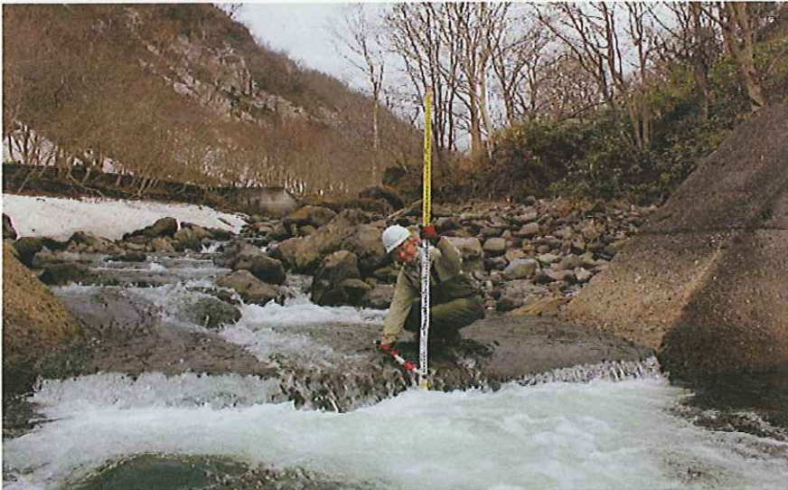
複断面放水路より1.00m洗掘
