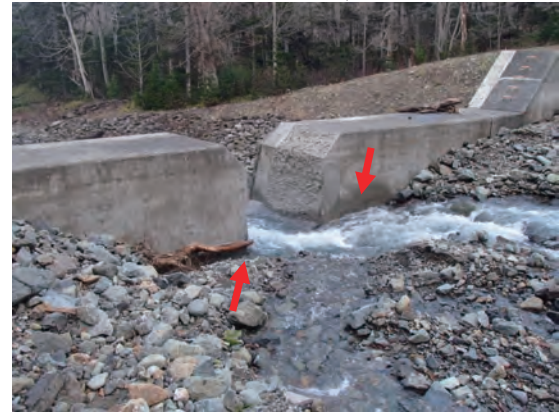
出水後の状況(11月15)
