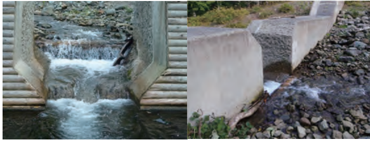
ピリカベツ川No8、10ダムのスリット部流木堆積状況. 40cmの落差を生じていた(9月25日)
