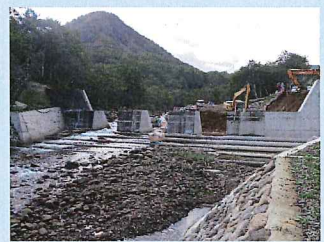
▲砂防ダムのスリット化
