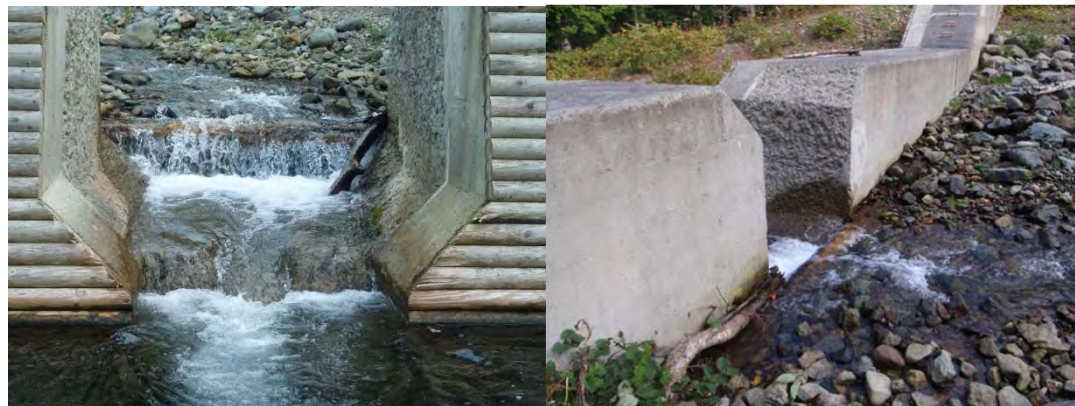
ピリカベツ川No8、10の流木堆積状況
