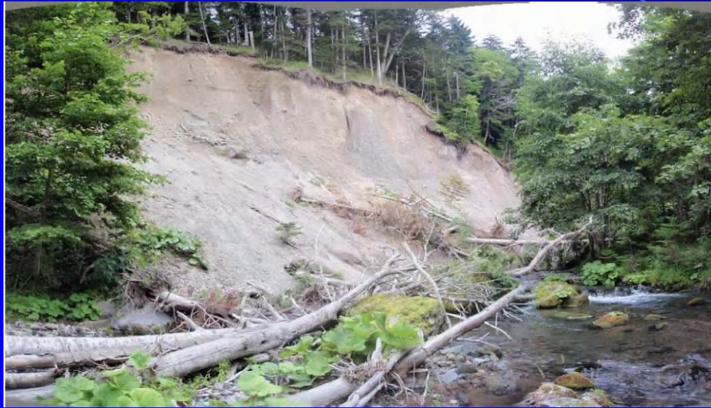
第1号鋼製えん堤上流の溪岸崩壊地
