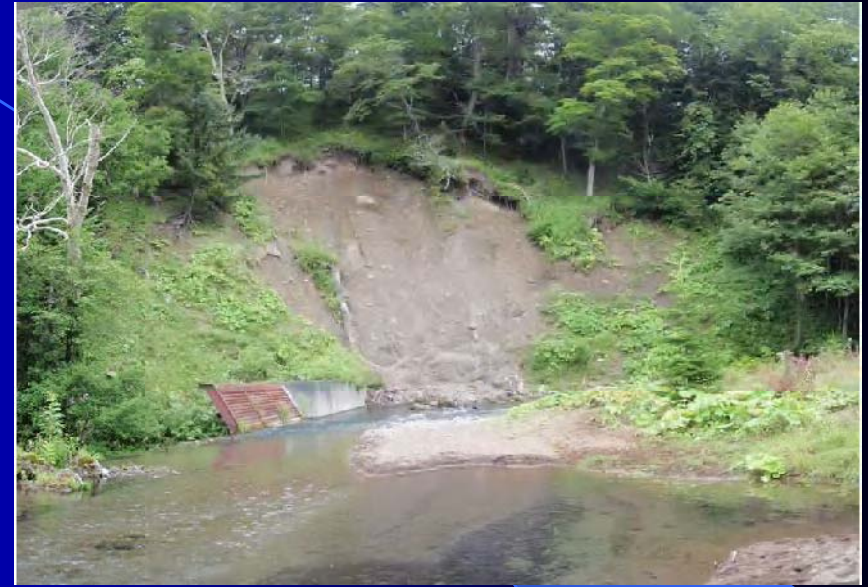
第2号鋼製えん堤上流の溪岸崩壊地
