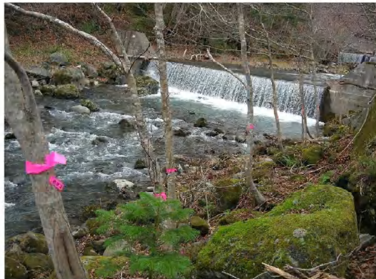
改修施工前 (H18.11撮影)
