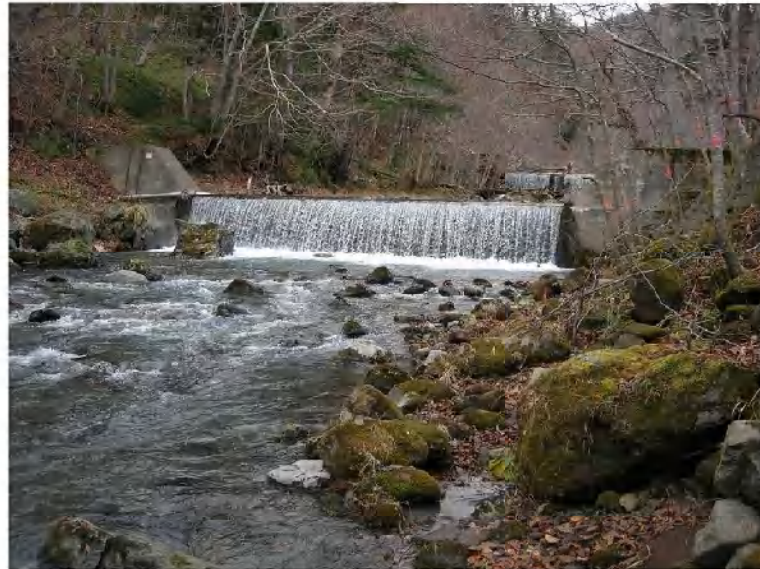
改修施工前 (H18.11撮影)
