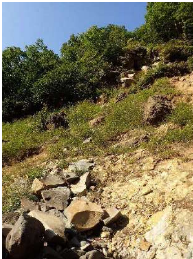
⑭斜面上部に不安定な谷壁
