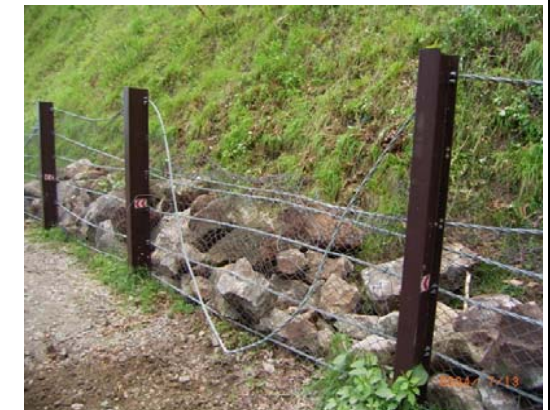
落石除去による既設防護柵破損状況
