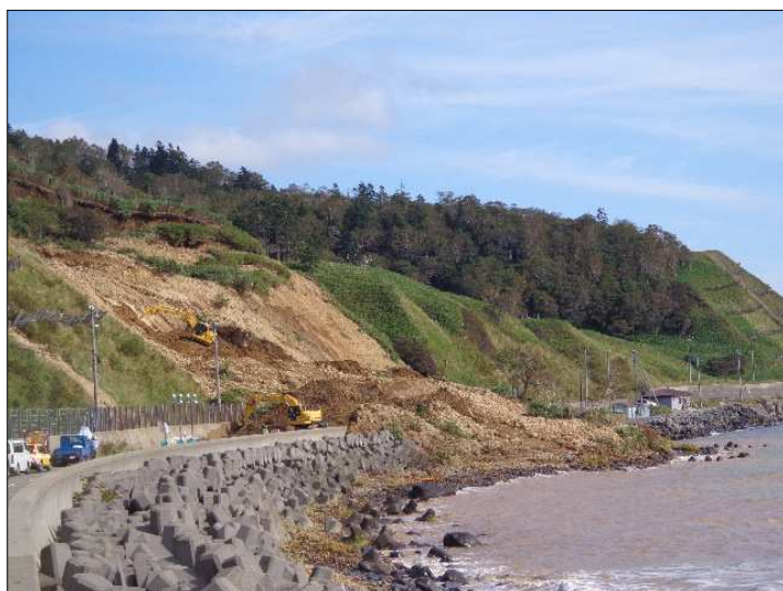
9月9日にルサ以北の熊岩近くで発生した大規模な土砂崩れの様子（写真提供：羅臼町）
