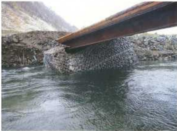
～No.2 左岸側橋台の傾斜状況～
