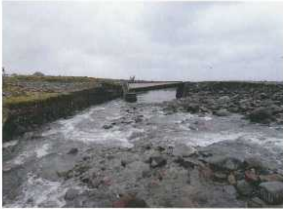
～No.1 ルシャ川上流から橋の損壊及び渓岸浸食状況～
