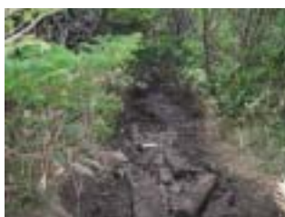
歩道のぬかるみ及び土壌浸食状況
