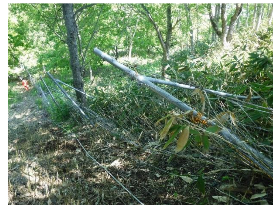
写真. 倒壊箇所の状況
