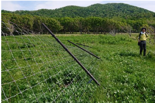
修繕対象例① 風雪等による倒柱
