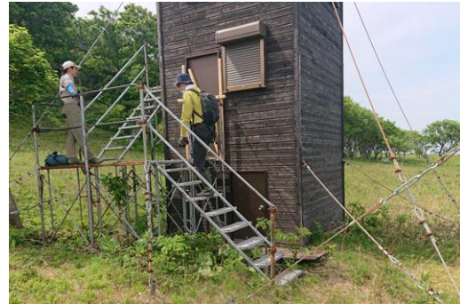
修繕対象例② 既設ハイタワーの老朽化
