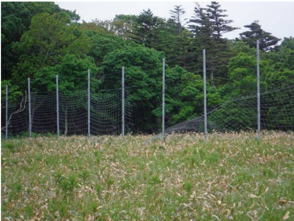
地点 D : 金網接続部が大きく離開. シカ通過可能 (2015 年).
