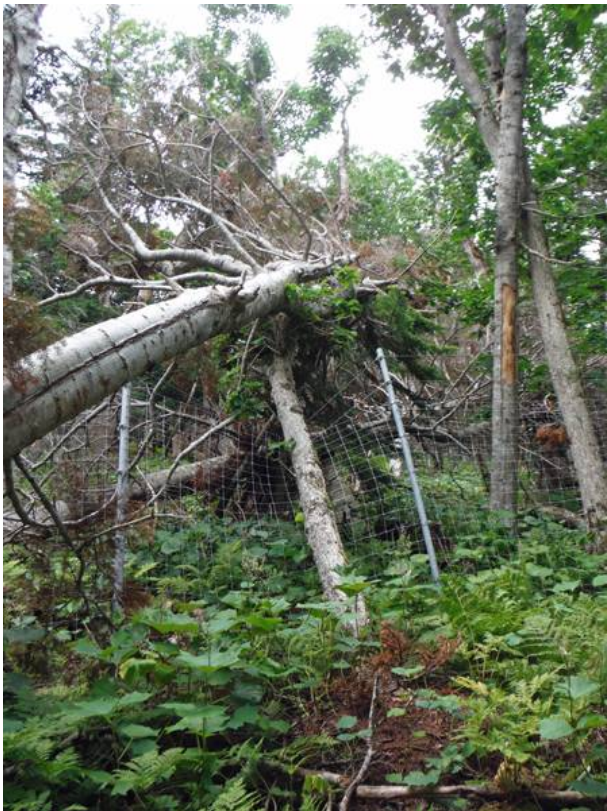
地点 Mo12 : トドマツ+広葉樹計 2 本の倒木で金網 1 スパンずり下げ。 さらに Mo11 との間で 10 スパンに傾きあり (2014 年)
