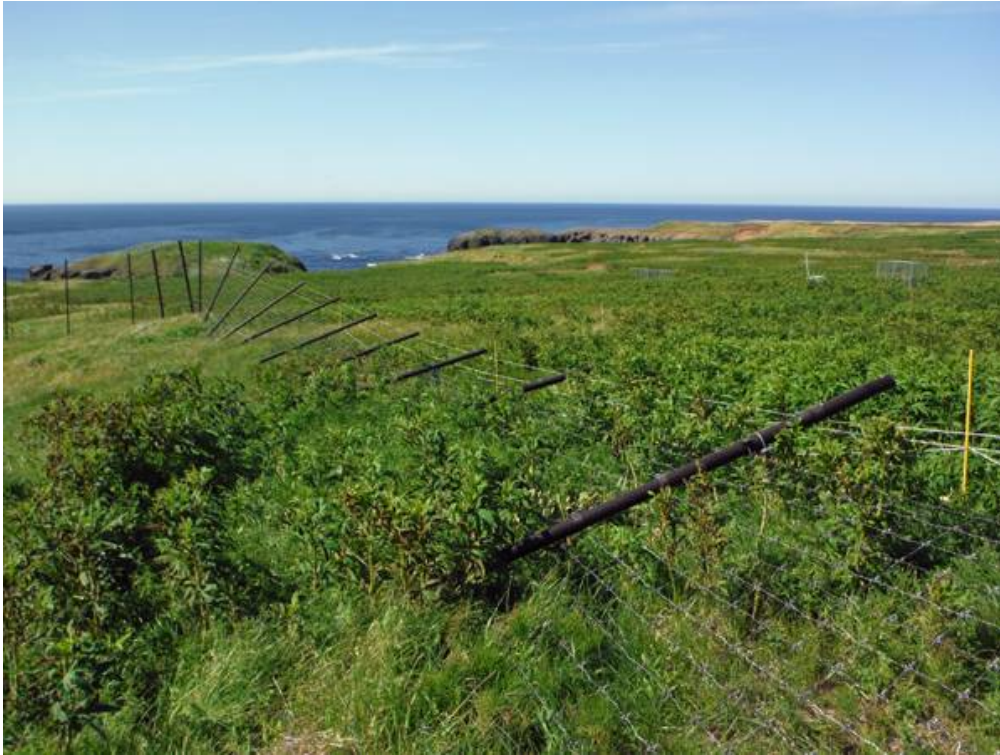
文吉湾入口（地図上地点 A）：仕切り柵が大きく傾いている。一部の支柱は金属疲労で破断。金網と支柱が宙に浮いて振動している状態（2015年）。
